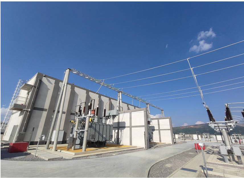
110千伏鸿鹄(大树营)输变电工程 供图
