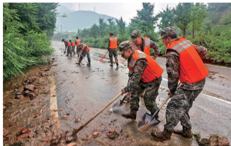
27日,武警官兵在密云区白河大桥南侧清理淤泥抢通道路 新华社发(王希庆 摄)
