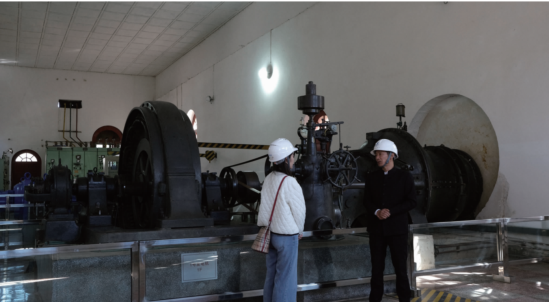
1912年投产发电的机组仍在正常运行
