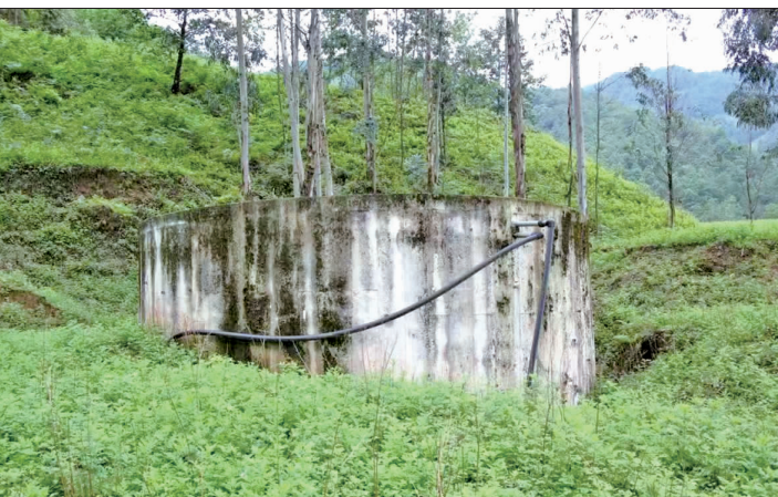
为村民供水的过滤水池 供图
