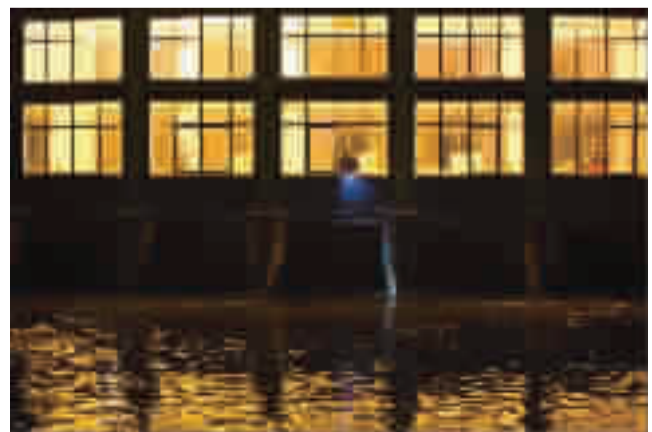
中泵站，工作人员观察水位在抽排下是否有所下降
