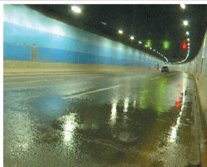
此前网友拍到的隧道漏水情况 网络截图
